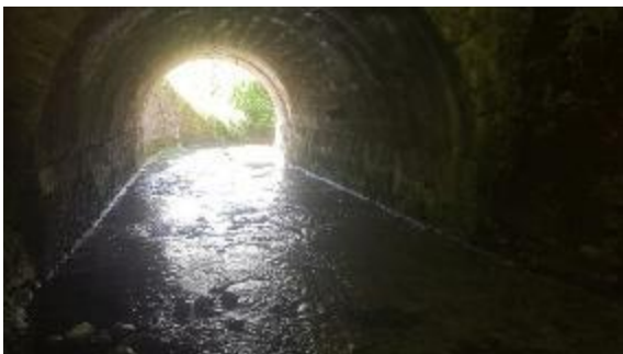
Durchlass vor Instandsetzung:
